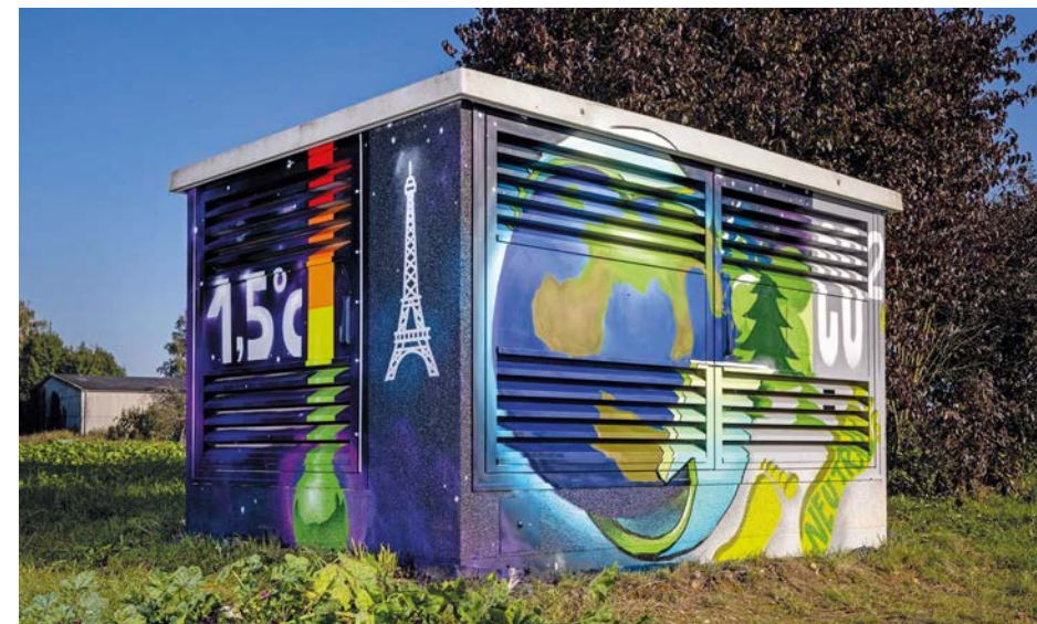
Eine Ortsnetzstation in Ostfildern-Nellingen repräsentiert die Bedeutung des Klimaschutzes für die Netze BW.
