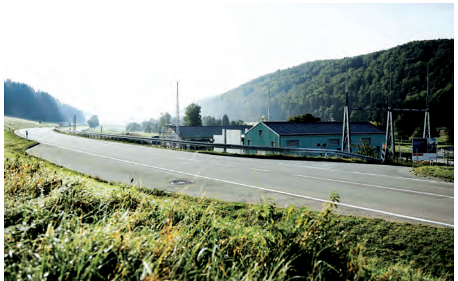
Umspannwerk in Baden-Württemberg
