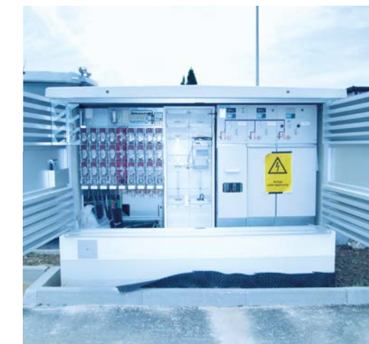
Netze BW Sparte Dienstleistungen projektiert, baut und übernimmt die Betriebsführung für Ihre Mittelspannungs-Anlagen
