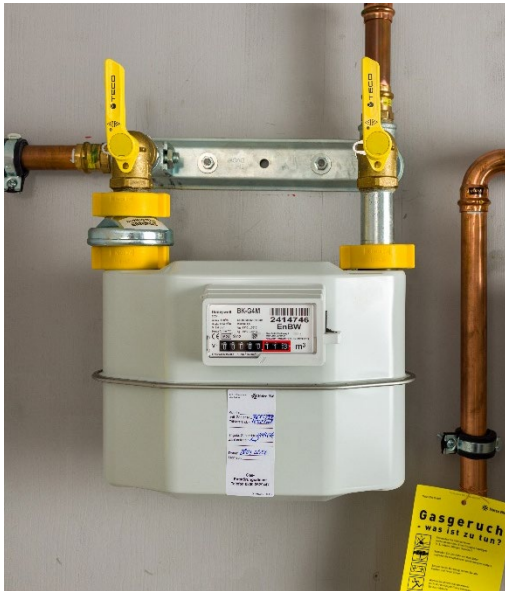
Abbildung 8: Balengasähler mit Zählerregler
