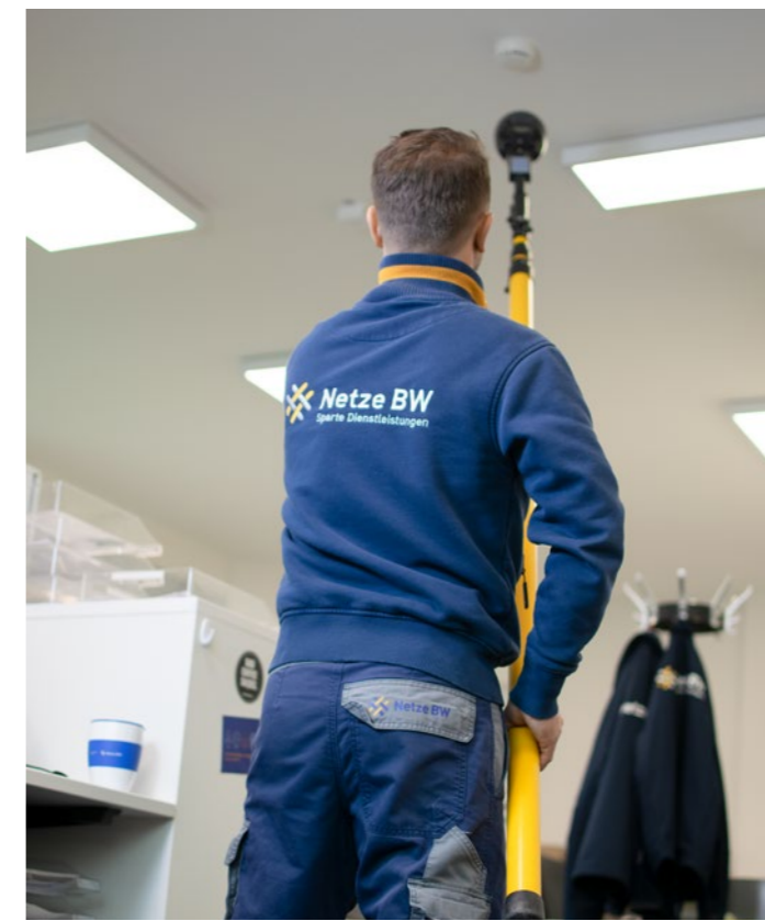
Funktionsprüfung von Rauchmeldern
