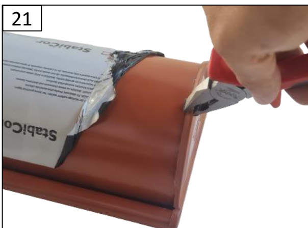
21 Lemovania vzájomne zalisovať kliešťami. Pri farbených plechoch je vhodné miesto lisovania vhodne chrániť pred poškodením farby
