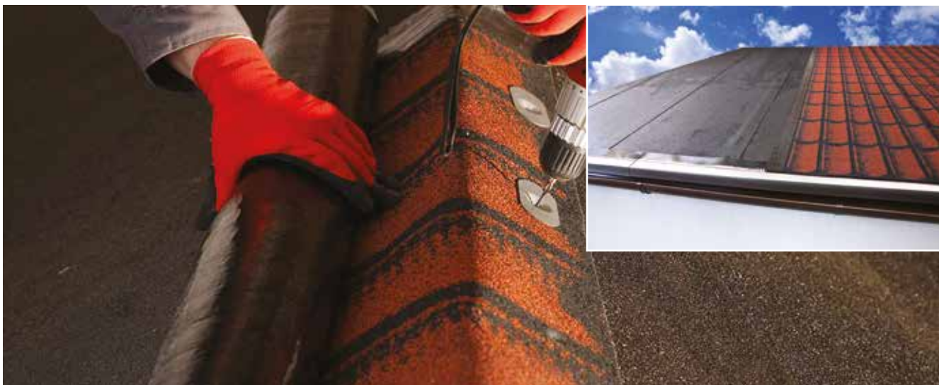
Rozměření a položení pásu RDI 3D na střechu a zahájení montáže od hřebene
