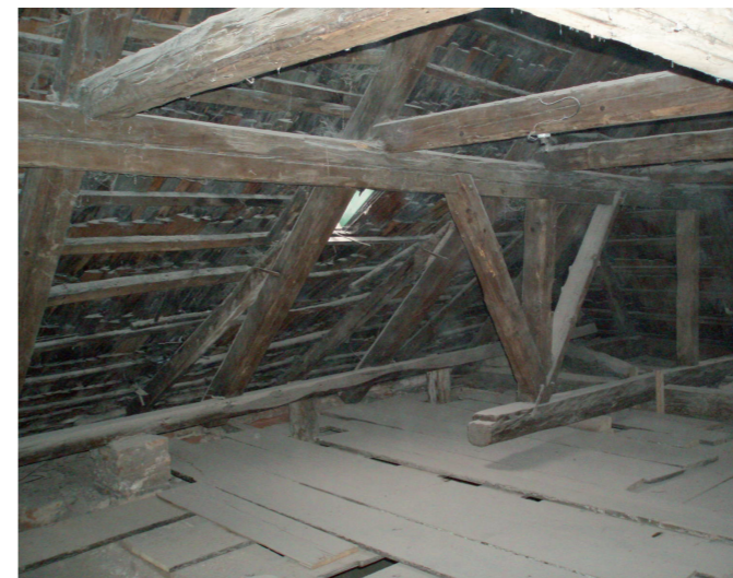
Střeška byla před rekonstrukcí v havarijním stavu, dřevo bylo napadeno dřevokazným hmyzem a proto proběhla kompletní výměna střešky.
