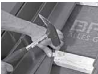
Rama de etanșare din tablă se fixează cu clemele de tablă, astfel încât să stea pe șicile suport cât mai bine
