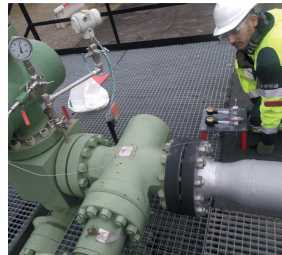
Prélèvement sur site de gaz annulaires* des puits.
