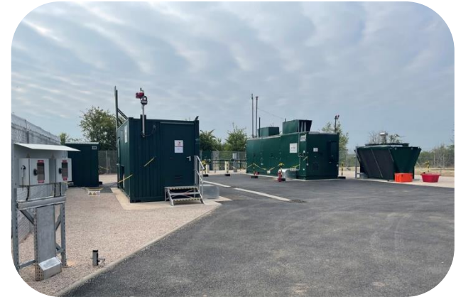
Rebours d'Argentan (61), mis en service le 03/05/2022
